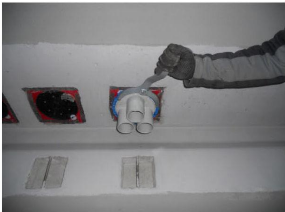
Abb.1: Festziehen der Kabeleinführung
