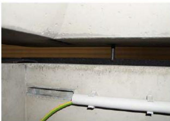
Führungsbolzen zwischen Trafo- u. Niederspannungstüre
