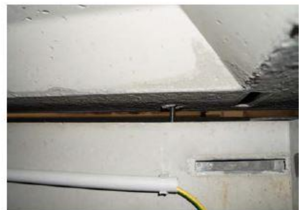
Führungsbolzen zwischen Mittelspannungstüre u. Lüftungsgitter
